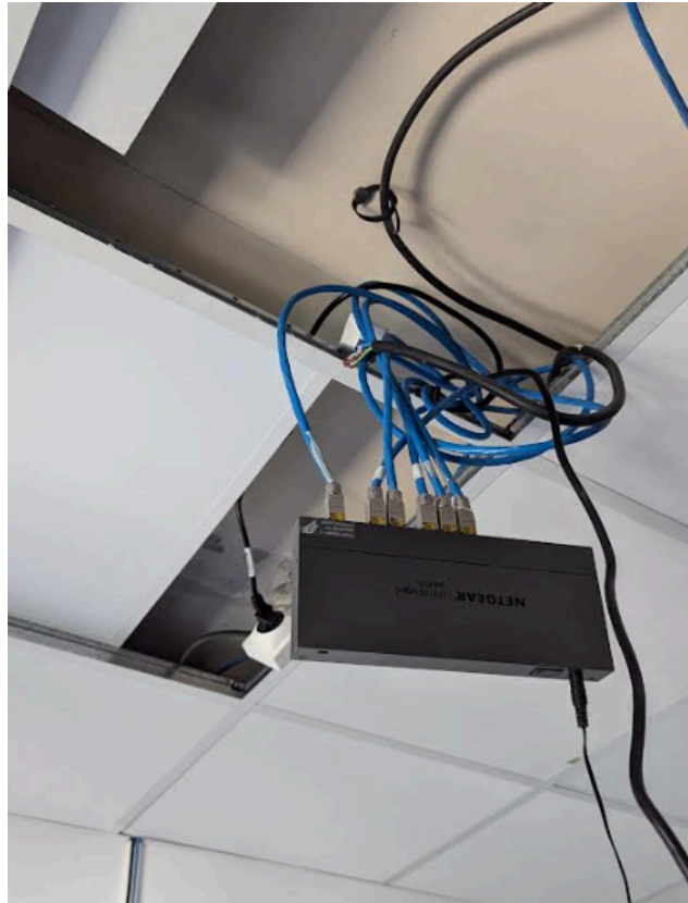
Figure 15 : Switch dans le plafond
